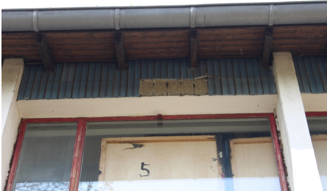
Witterunseinflüsse führen zu Spaltensystemen. Hier: abgesprengte Fassadenelemente.
