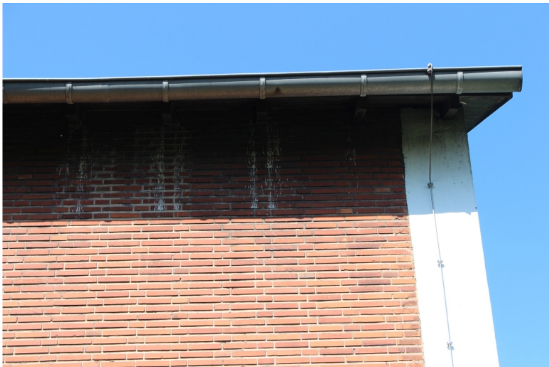
An sehr vielen Dachsparren erkennt man diese Spuren. Sie wurden genauer untersucht und entpuppten sich als bautechnische Substanzen, die an den Dachsparren früher zum Einsatz gekommen sein müssen. Auswaschungsprozesse stellen eine andere Erklärungsmöglichkeit dar. Vogelkot, dies ließ sich aus der Nähe betrachtet feststellen, ist es definitiv nicht.
