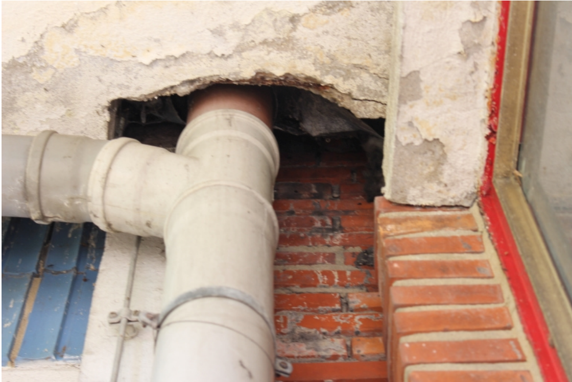
Höhlung am Durchbruch eines Fallrohrs.
